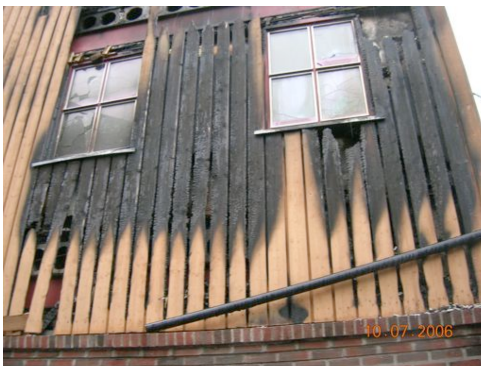
Bilde 5.1.2 i Brannspredning inne i veggen (i det brennbare isolasjonssjiktet).
