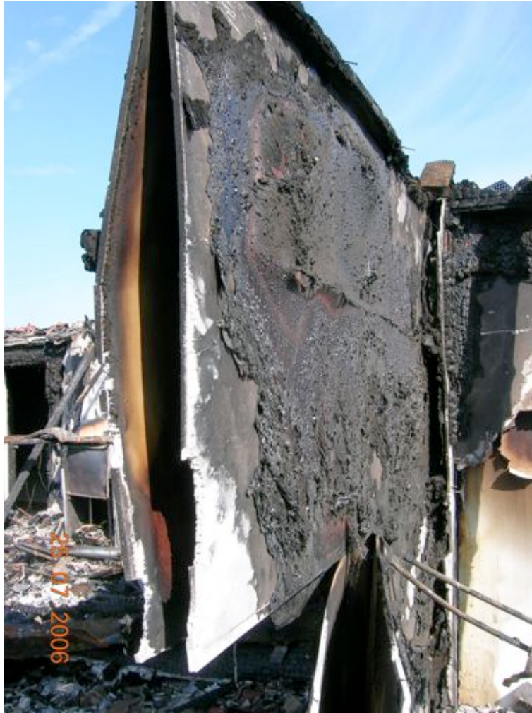
Bilde 5.1.2 d Rester av skillevegg som skulle vært A 60. Det er i stedet benyttet 2 stk. MultiElement satt inntil hverandre.
