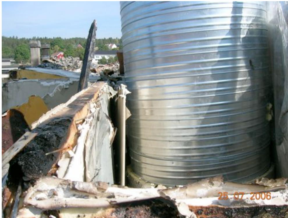
Bilde 5.1.2 f Ventilasjonssjakt med vegger av MultiElement.
