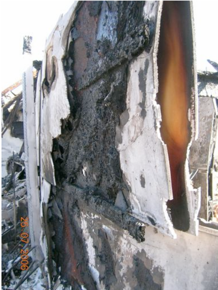
Bilde 5.1.2 e: Rester av skillevegg som skulle vært A 60. Det er i stedet benyttet 2 stk. MultiElement satt inntil hverandre.
