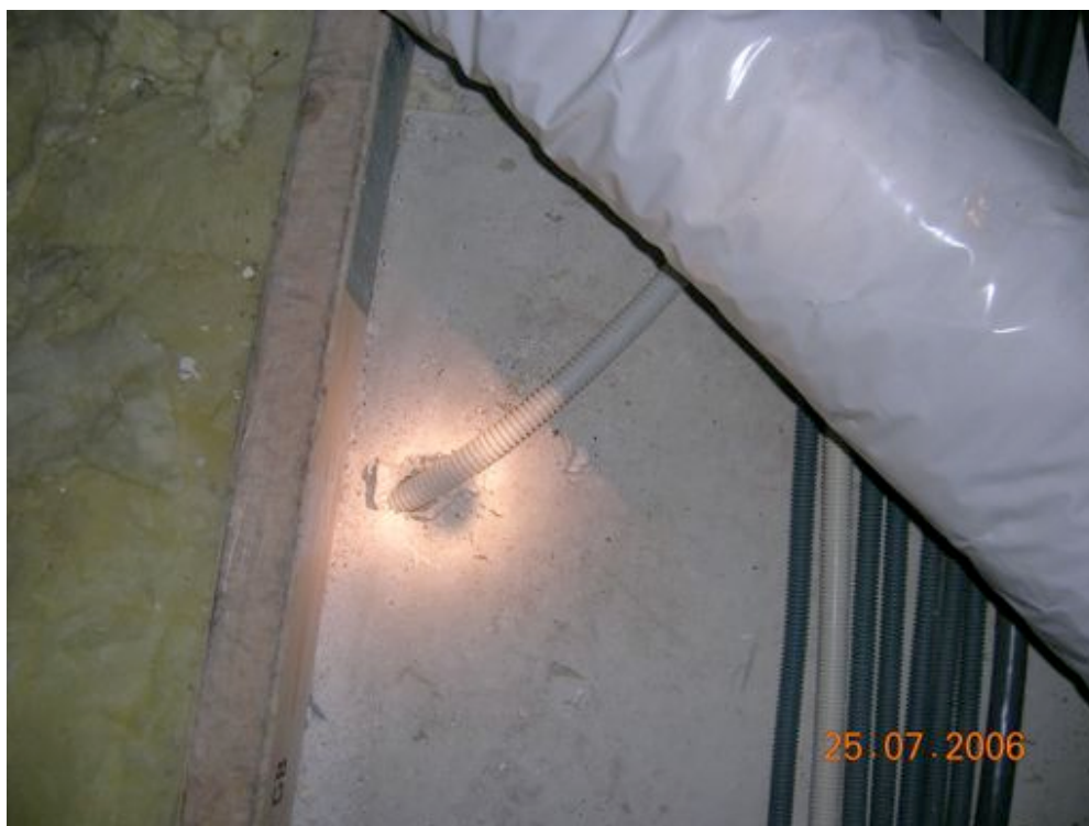
Bilde 5.7.3 b Trekkerør ført gjennom etasjeskilleren mellom leilighet og loft i blokk A.
