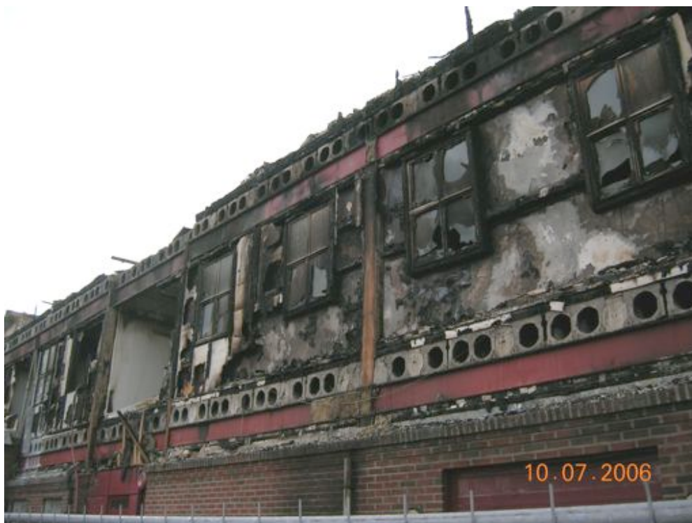
Bilde 5.1.2 h All brennbar isolasjon i fasaden – og utenforliggende gipsplate og trekledning, er borte. Kun innerste gipsplate gjenstår.
