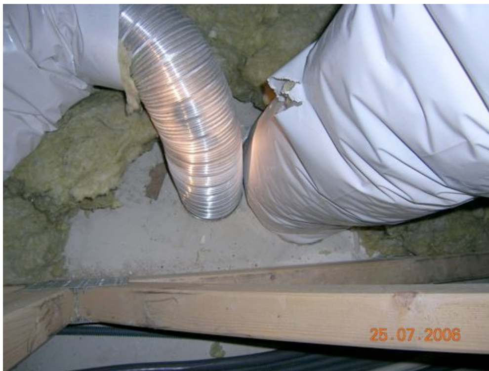
Bilde 5.7.3 a Gjennomføringer fra leiligheter til loft i blokk A. Fleksibel kanal er delvis uisolert.
