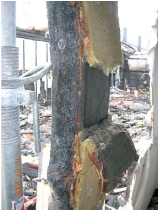
Bilde 5.1.2 l Brannpåkjent søyle i yttervegg blokk B, akse Y 11.
