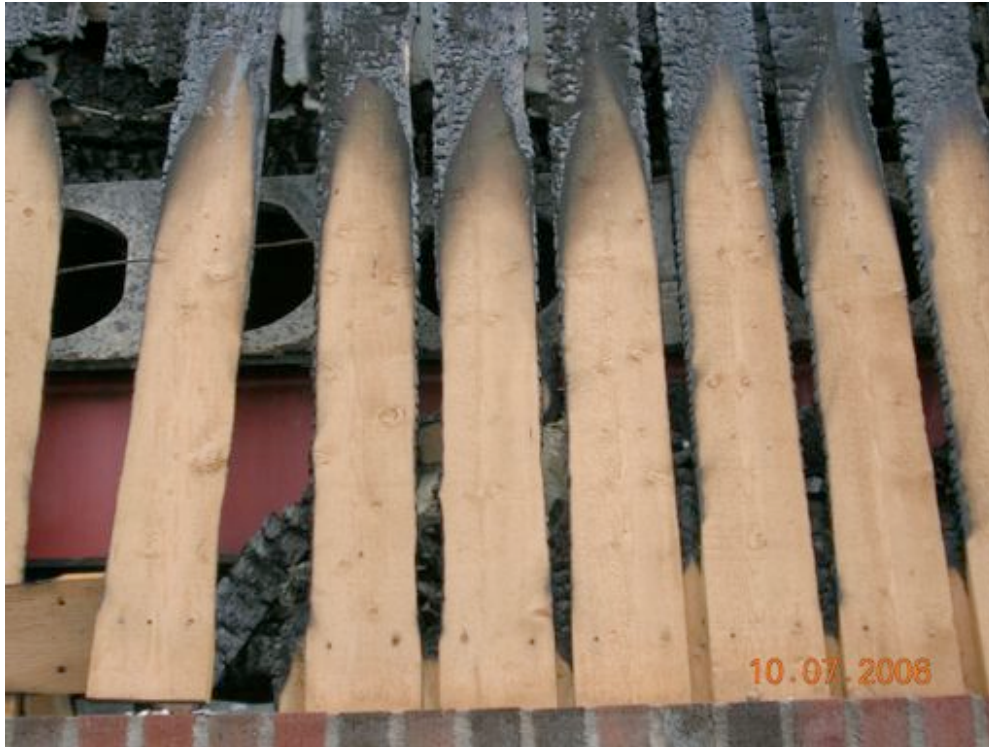
Bilde 5.1.2 j Brannspredning inne i vegg (i det brennbare isolasjonssjiktet). trekledningen er brannpåkjent fra innsiden. Underliggerne er bortbrent.
