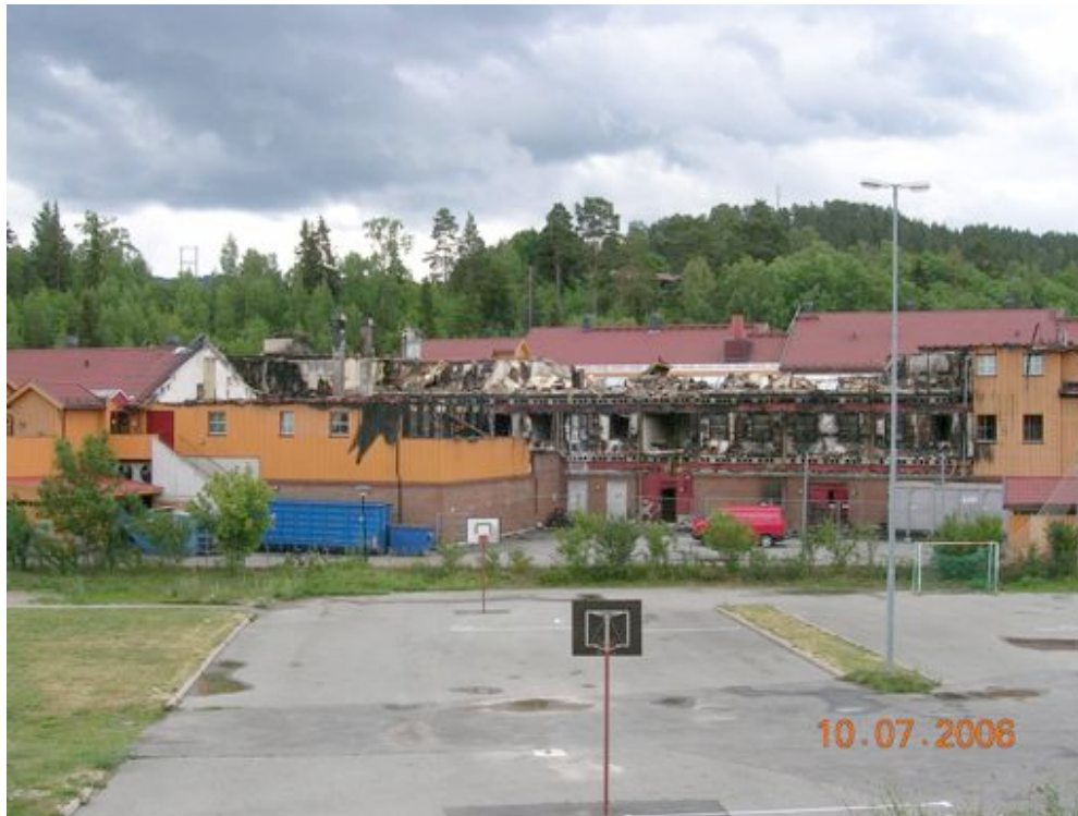
Bilde 4.3.2 Etter brannen. Midtre parti av blokk B og deler av blokk C, sett fra vest.
