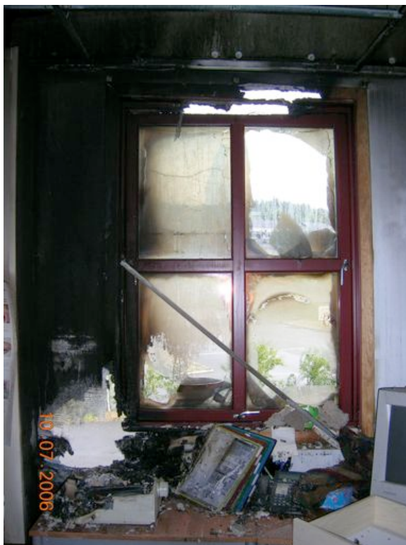
Bilde 5.1.2 k Brannspredning utenfra gjennom yttervegg.
