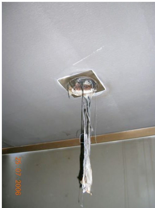
Bilde 5.1.2 b Rester etter lampekuppel i plast som er smeltet etter brannpåkjenning ovenfra.
