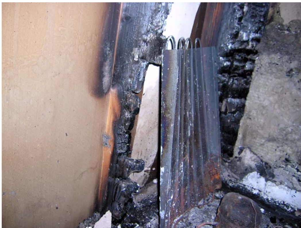
Bilde 1. Rester av kjøleskapet i lintøyrommet.
