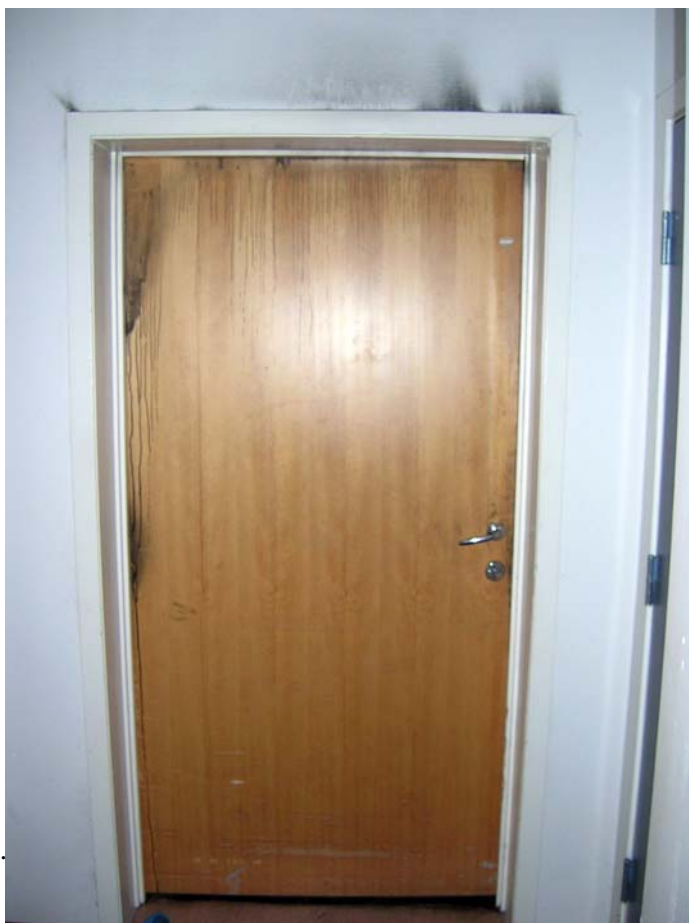
Bilde 6. Spor etter røykgjennomtrengning ved dør til bygning B.
