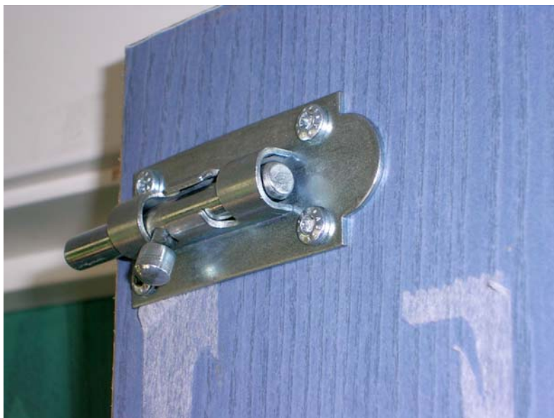
Bilde 8. Haspe (øverst på dørblad) som ikke er lett å finne i en røykfylt korridor.
