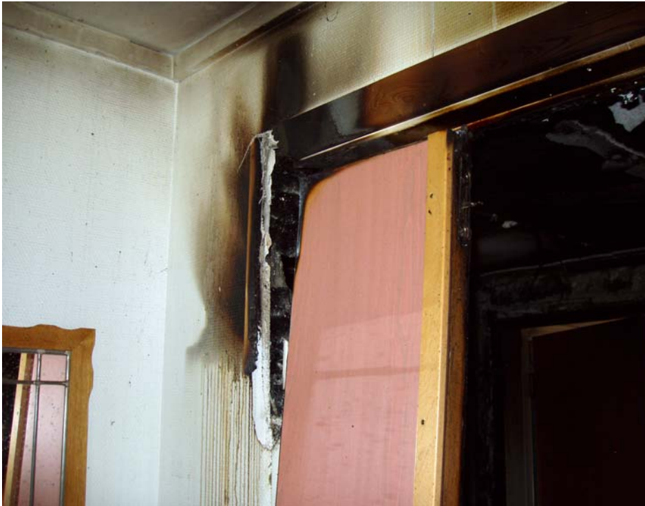
Bilde 10. Gjennombrenning mellom karm og vegg ved dør til tidligere hobbyrom.
