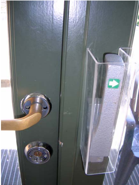
Bilde 7. Låseanordning på dør som stiller store krav til fysisk styrke for å kunne åpne.
