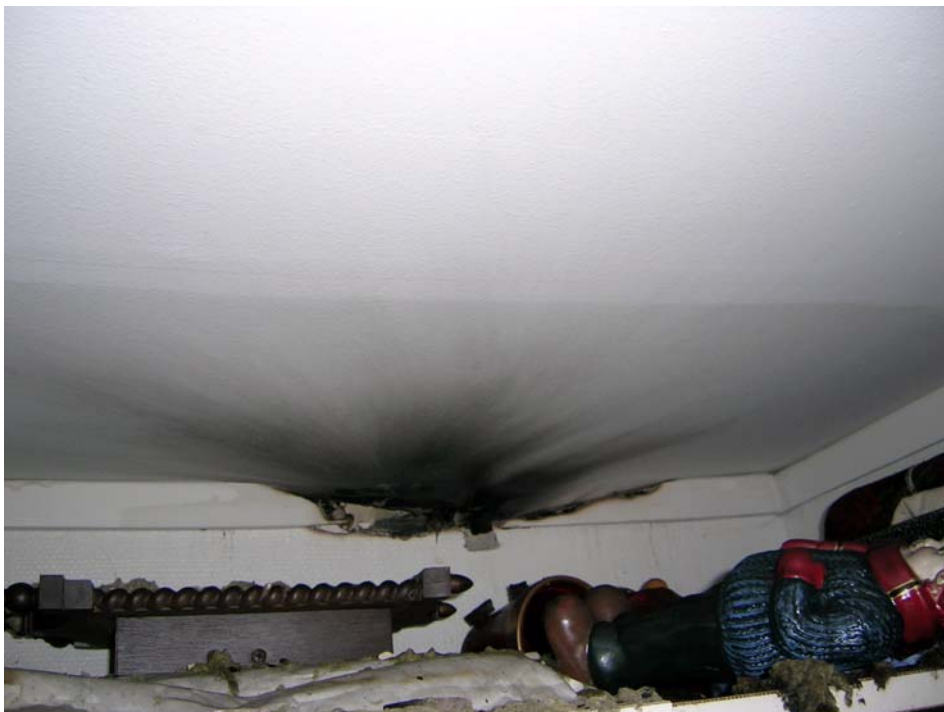
Bilde 11. Utilfredsstillende tetting mellom vegg og himling mellom korridor og tidligere hobbyrom.
