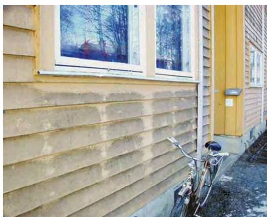
Bilde 5.1: Svortesopp kan forekomme p.g.a. dårligere uttørking ved temperatursenkning på yttervegg. (Byggforsk)
