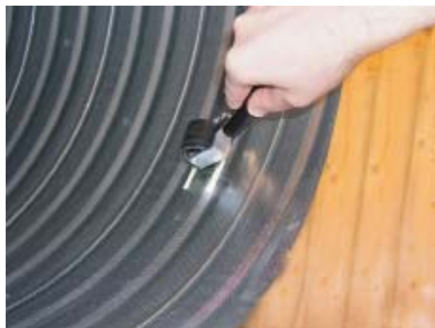
Prøvetaking med gelteip for måling av smussmengder. Prøve innhentes fra en representativ del av overflaten, for eksempel 45° opp fra bunnen av kanalen, som vist her. Foto: SINTEF Byggforsk
