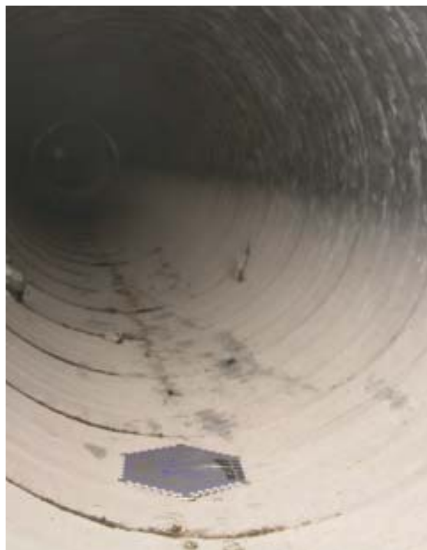
Tilsmusset tilluftskanal. Sekskanten som ligger i bunnen av kanalen kan brukes til å måle tykkelsen på smussjiktet. Foto: Lifa Air Ltd. Finland
