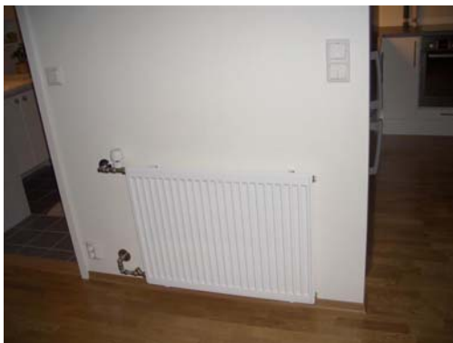
Figur. 5.3 Løvaashagen i Bergen. Radiator Superisolerte plassert på innervegg (Foto: M.Våge)
