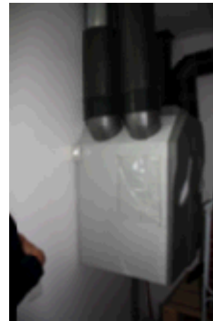
Figur 8.14: ventilasjonsanlegg med varmeveksler
