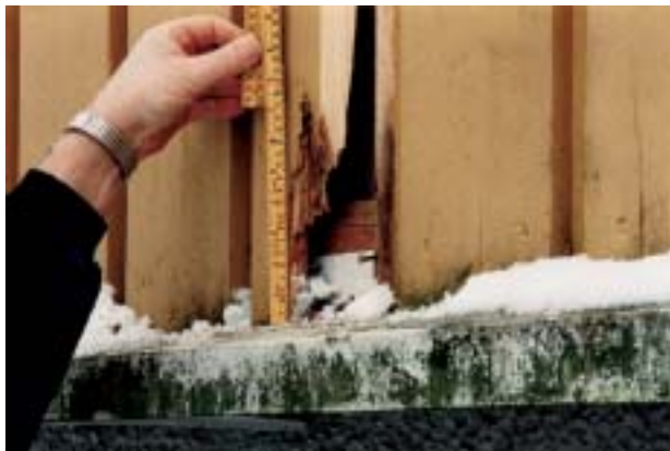
Kapillær transport av vann fra et beslag har ført til råte i trekledning. Foto: SINTEF Byggforsk
