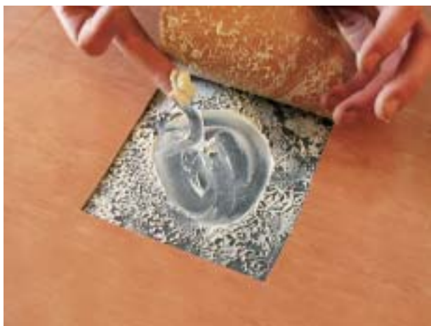
Mangelfull uttørring av et betonggolv før det limes et tett belegg kan føre til oppløsning av limet, med lukt og redusert heft som resultat. Foto: SINTEEF Byggforsk
