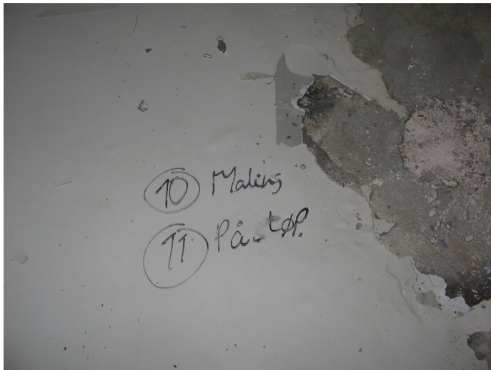
Figur 28: Avrettingsmasse under maling på malt betonggulv
