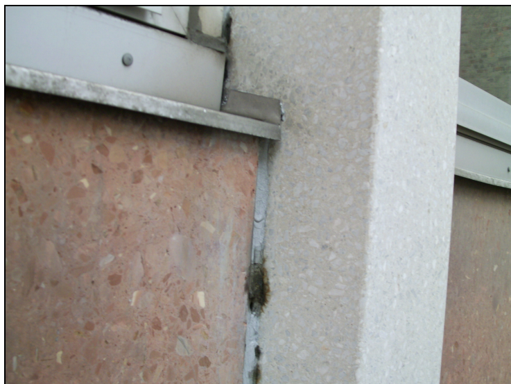
Figur 18: Lys grå fugemasse mellom betongelementer
