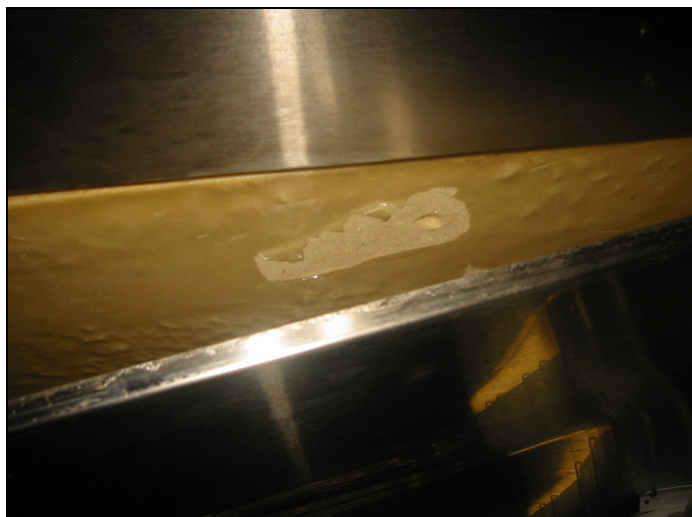
Figur 4 Polyuretanplate i tak i kjølerom
