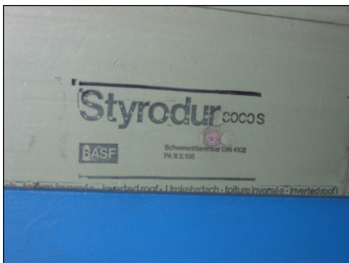
Figur 3: XPS-plate under kjørerampe i parkeringshus fra 1980-tallet.
