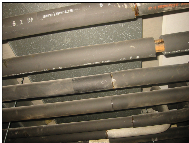
Figur 9: Cellegummiisolasjon på rør
