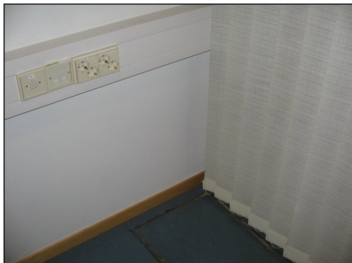
Figur 24: Kabelkanal i plast i kontorbygg
