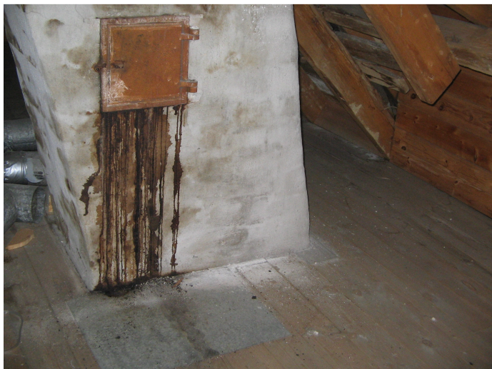
Figur 29: Murpuss på pipe på loft
