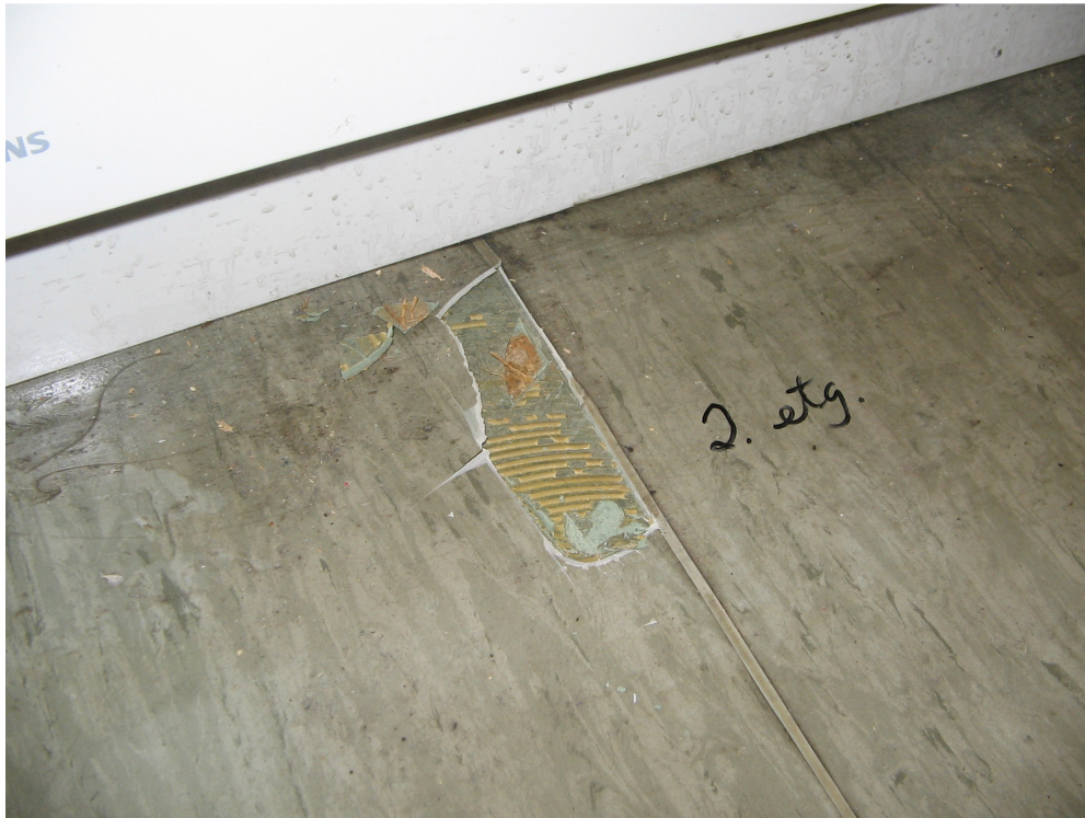
Figur 12: Vinyl gulvbelegg (Belegget på bildet har DEHP = 53.000 mg/kg, og er farlig avfall.)
