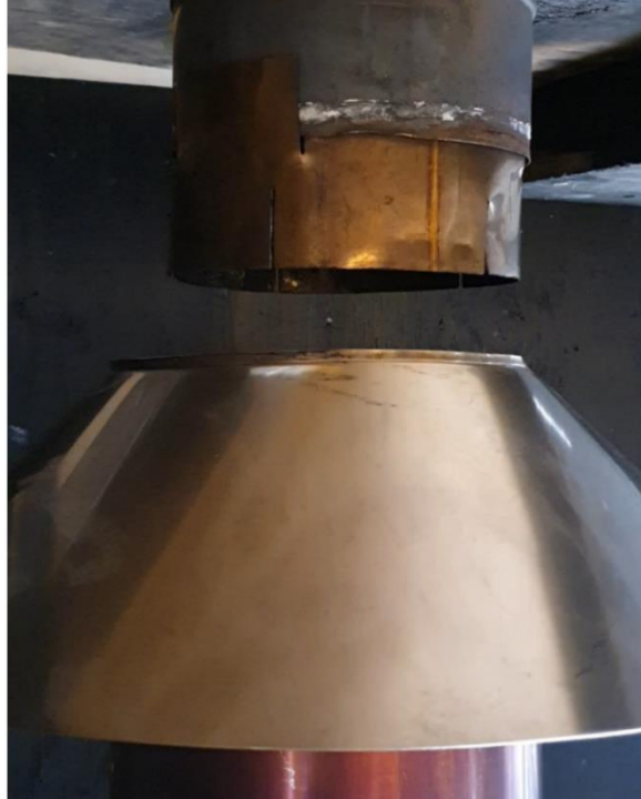
Figur 3-13: Åpning mellom skorstein fra testgrill og ventilasjonskanalen.
